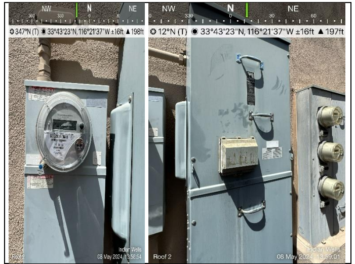
20. Roof 2 standalone meter
